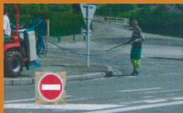
Les caniveaux et bouches d'égout
